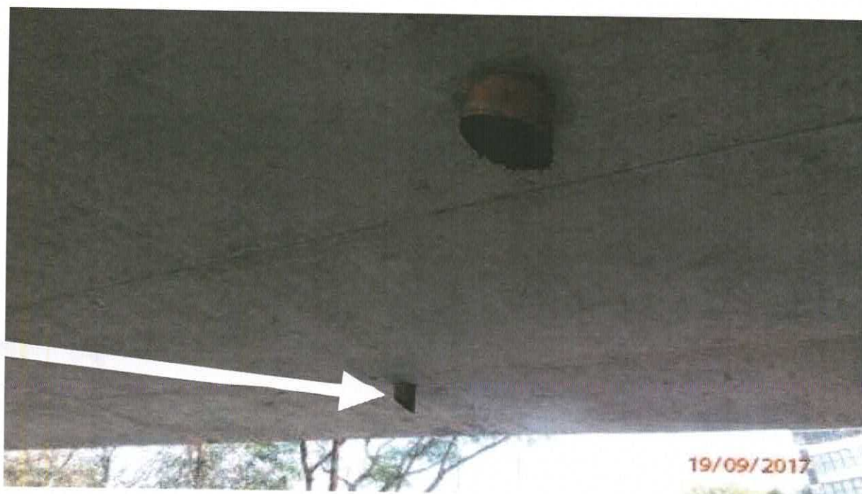
Foto: Exemplo de buzinate para escoamento de água dos caixoes perdidos da laje.
