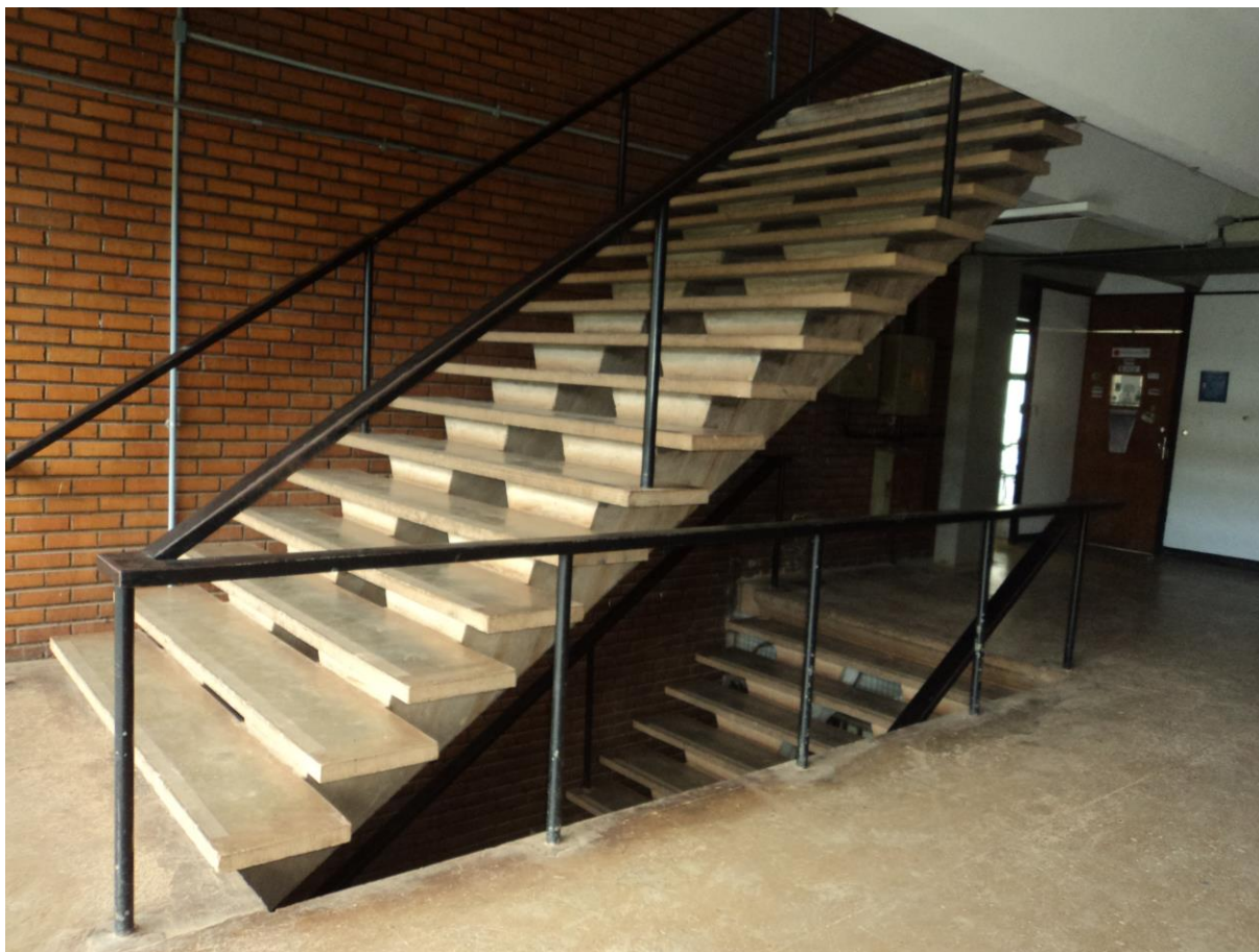
Figura 1 – Escada original do bloco A, em desacordo com as normas atuais.
