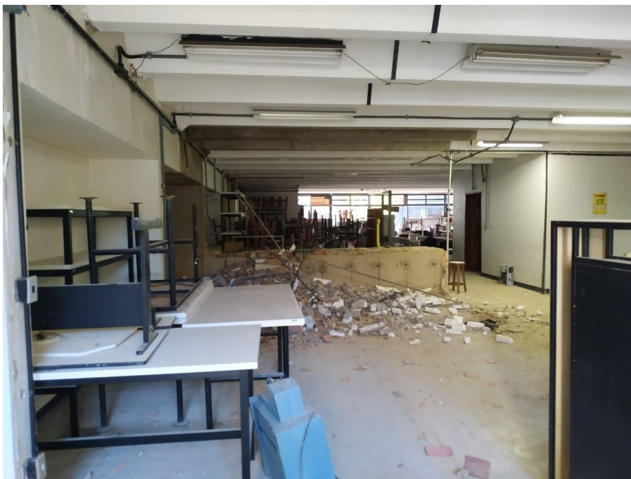
Figura 3 – Demolições não concluídas.
