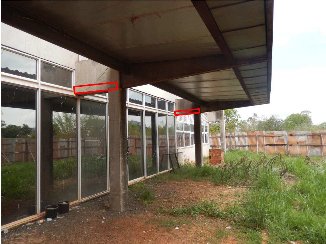
Figura 11 – Fachada oeste da edificação, em destaque seções aproximadas das lajes que não foram executadas.
