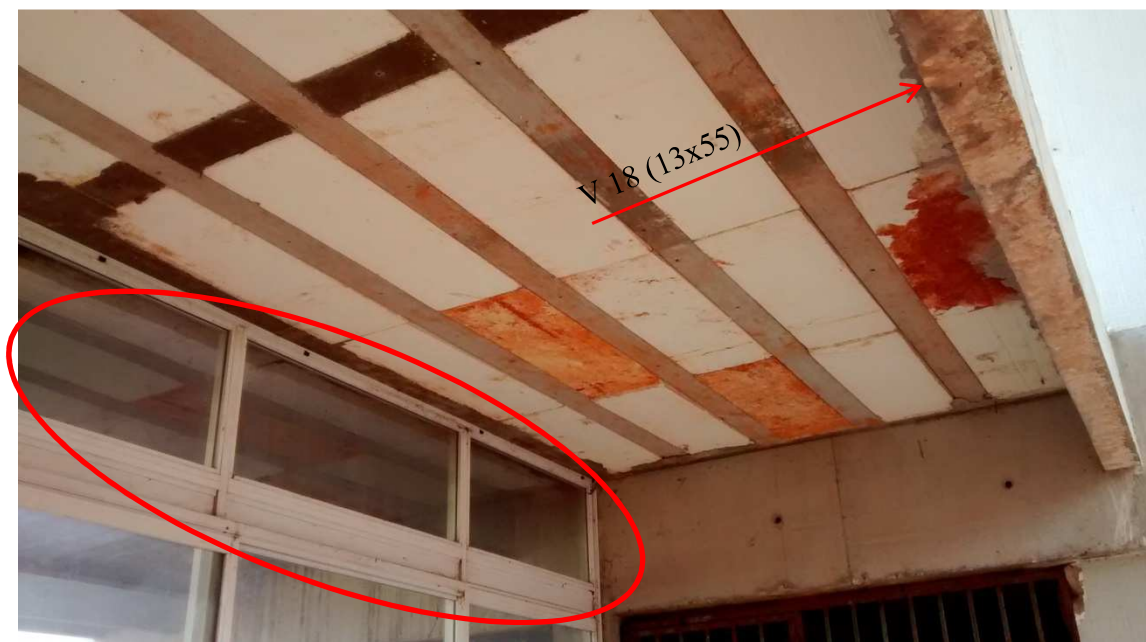
Figura 04 – Em destaque o local que deveria ter sido executada a parte inferior da viga V6, ao invés disso existe uma esquadria de alumínio e vidro.
