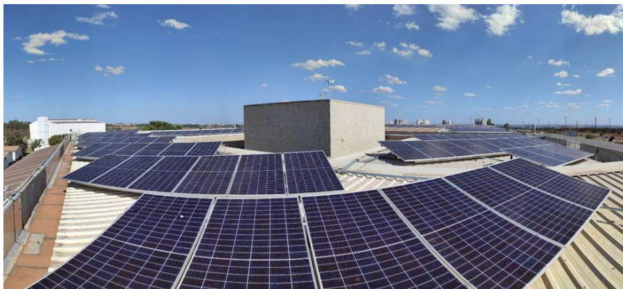
Foto 10 – Usina fotovoltaica FGA
