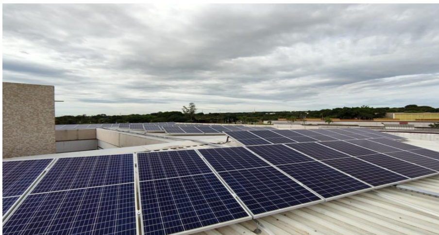
Foto 13 – Usina fotovoltaica UED/IPOL-IREL
