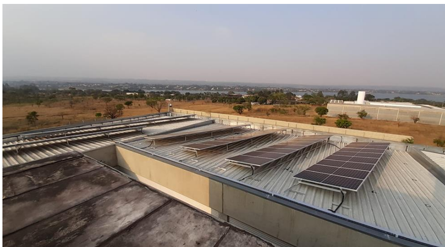
Foto 11 – Usina fotovoltaica UED/ICS
