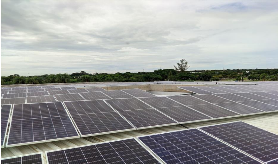
Foto 12 – Usina fotovoltaica UED/CIC-EST
