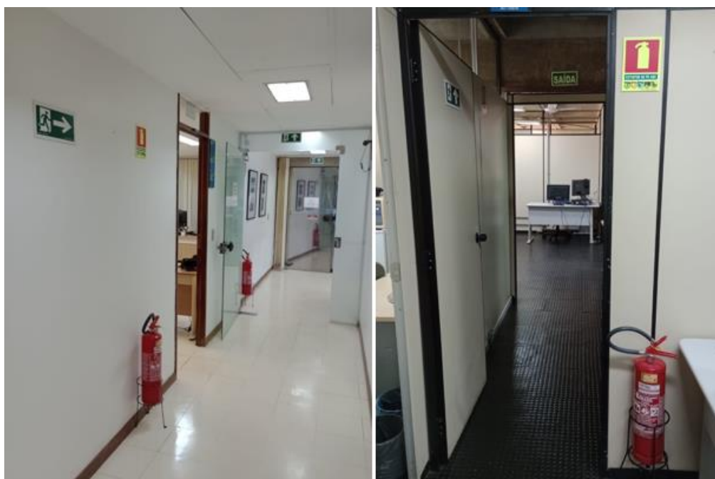
Foto 23 – Instalações de Combate a Incêndio - Reitoria. Fonte: DIMAP.
