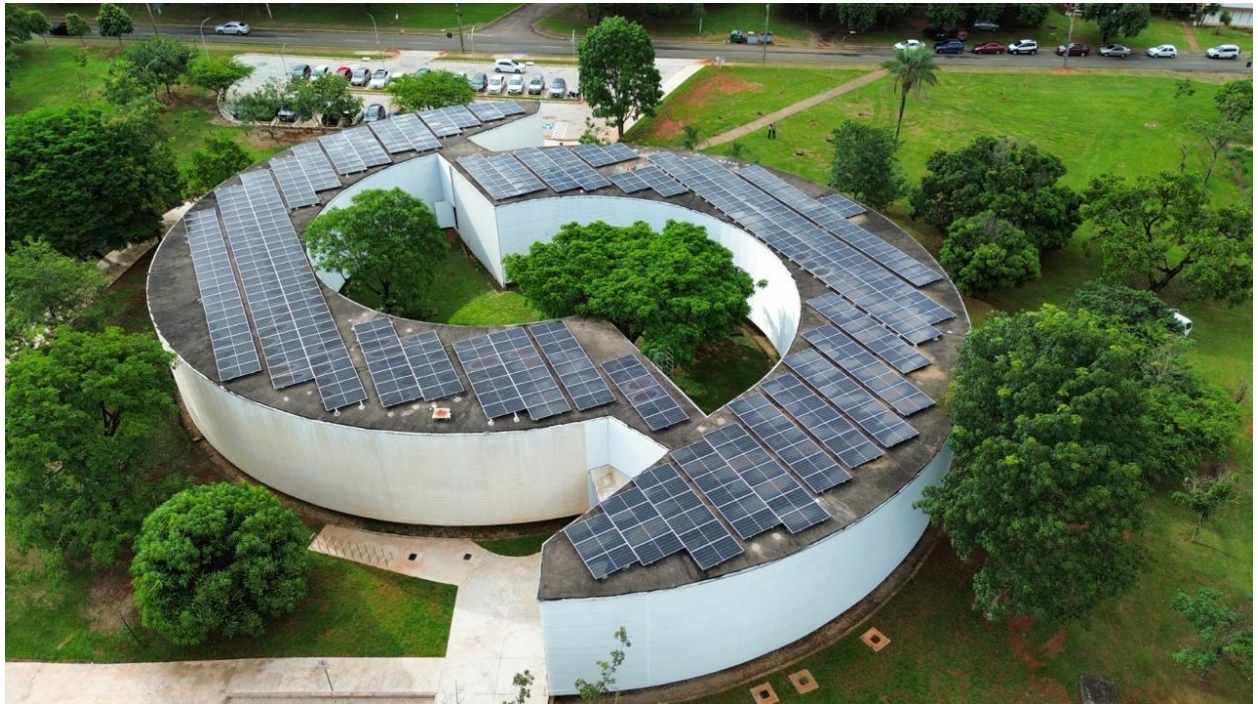
Foto 17 – CDS – Usina Fotovoltaica. Fonte: Secretaria de Infraestrutura.
