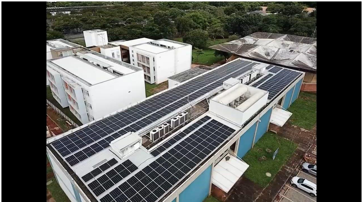
Foto 19 – ULEG-FT – Usina Fotovoltaica. Fonte: Secretaria de Infraestrutura.
