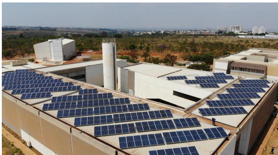
Foto 9 – Usina fotovoltaica FGA
