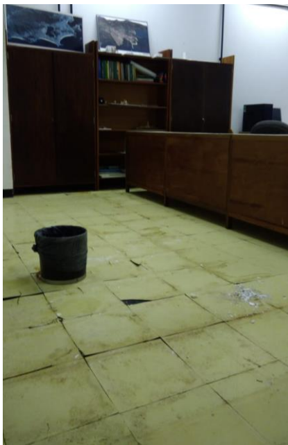
Figura 1 – Piso vinílico descolando.
